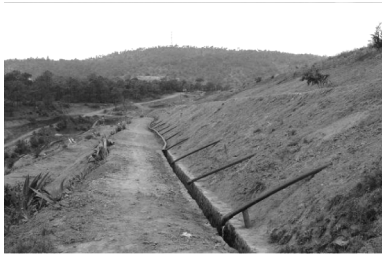
图 6 竣工后的第 8 级子坝处的排渗管 Fig. 6 The drainage tubes on the eighth sub-dam
