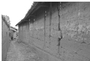
图1 海拉乡某生土结构房屋裂缝
