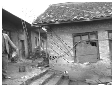
图2 东风镇黄泥村砖混结构房屋裂缝
