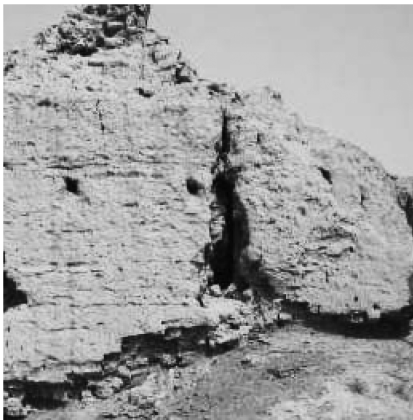
图 5 劈裂裂缝 Fig. 5 Cleavage fracture
