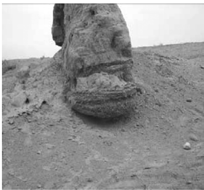
图3 墙体根部掏蚀
