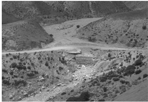
图 2 泥石流冲毁公路防护设施
