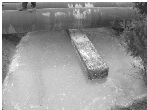
图 10 碱厂排污管道冒水现象
