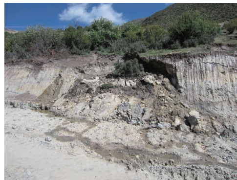
图 4 前缘公路边坡内侧滑塌
