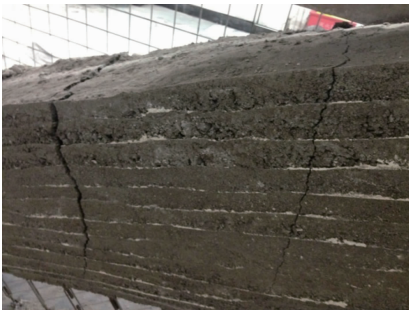
图 3 坡体中部裂隙
