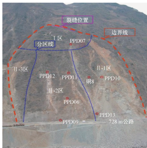
图 1 库首右岸拉裂变形体
