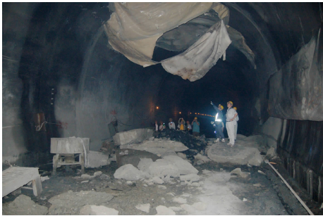
图 1 酒家垭隧道二衬垮塌
