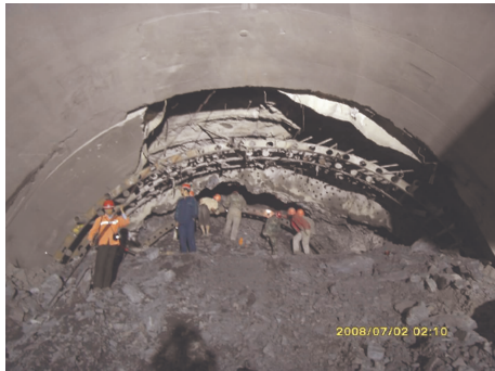
图3 龙溪隧道围岩垮塌
