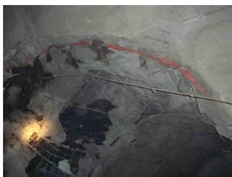
图9 龙溪隧道衬砌垮塌
