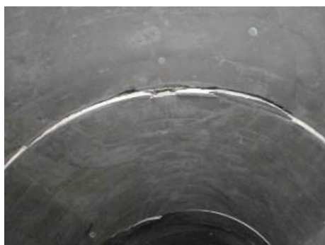
图10 龙溪隧道衬砌环向错台
