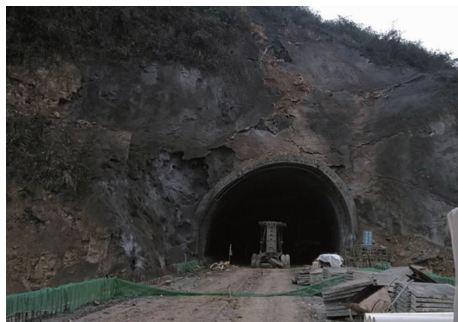
图1 左线隧道受挤压变形
