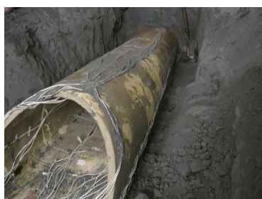
图 16 地震后隧道衬砌开裂情况
