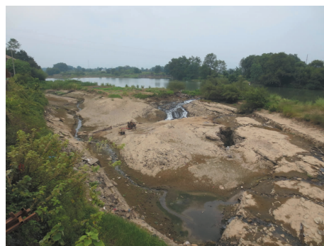
图 1 塌陷坑及部分河床
