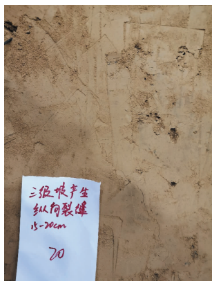
图 7 0.6g 时无支护侧的三级坡坡面裂缝
