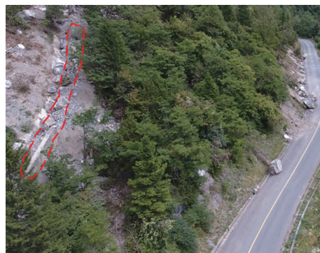
图1 “8·8”地震中损毁的拦石墙
