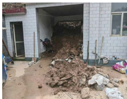
(b) 保定市满城区刘家台乡慈家台西坡崩塌
