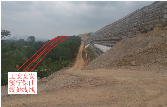
图 2 填方边坡现状照片
